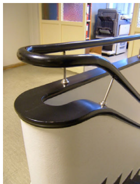
Rekkverk Foto: Leif Maliks, Forsvarsbygg.
