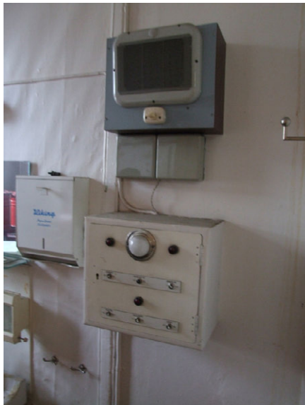
Alarmenhet vaktrom. Foto: Leif Anker, Forsvarsbygg.
